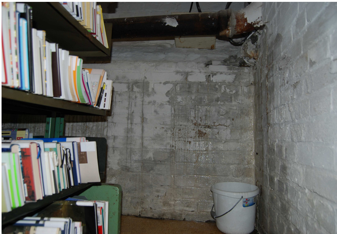
Foto č. 5: Promáčené zdi na jaře 2012
